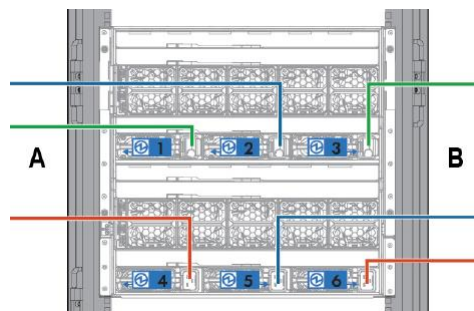
Synergy 12000 フレームの電源接続配分 1, 2, 4 は A 系(左側) PDU 接続 3, 5, 6 は B 系(右側) PDU 接続
