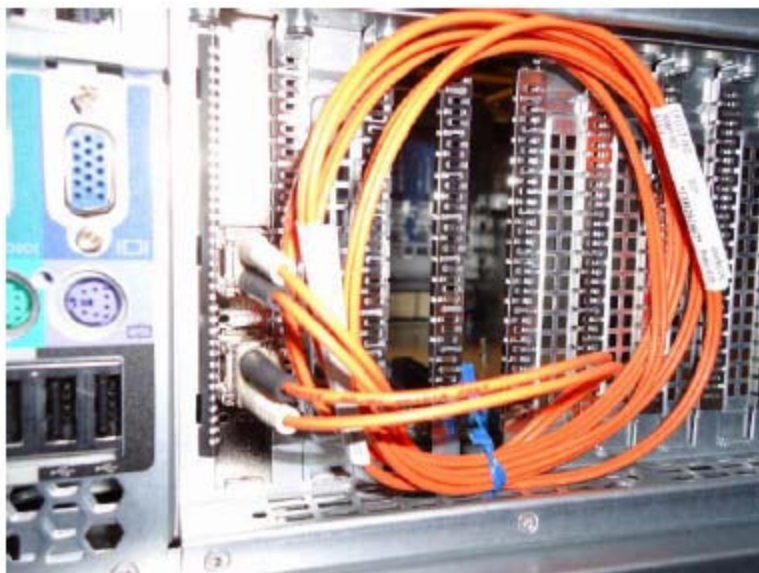
図 3: 仮想マシンをテストするための、PCIe NIC と GBIC モジュールの取り付け、およびファイバーケーブルの接続
